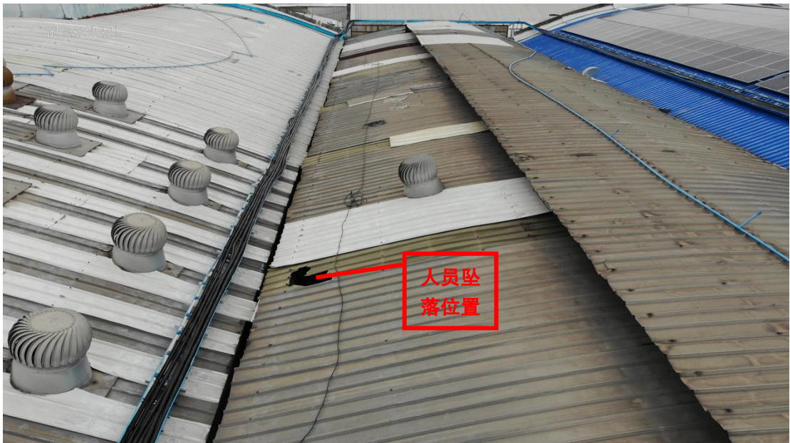
图 5 事故发生位置所在的屋顶区域概况
