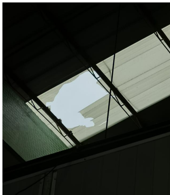
图 3 事故现场破碎的屋顶采光塑板
