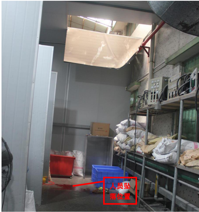
图 4 事故现场人员坠落位置
