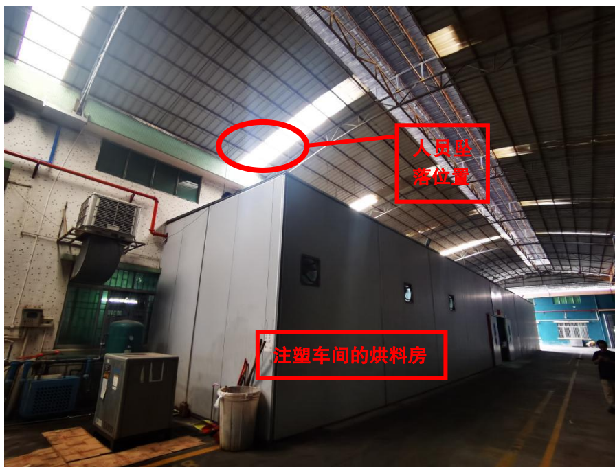
图 2 事故现场概况
